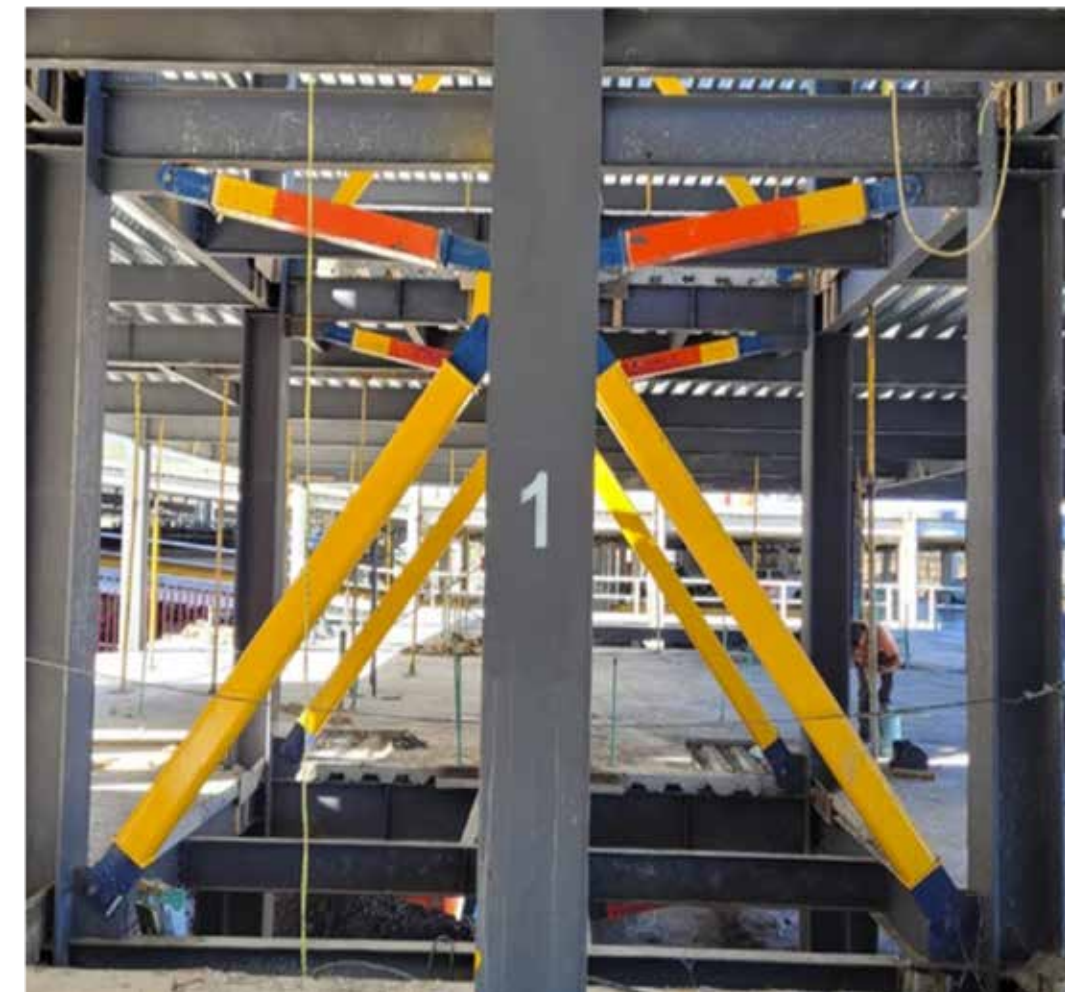
Figura 6. Uso de disipadores tipo Dampo BRB.
